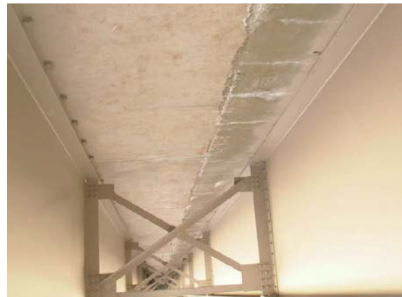
Figure C-111. Closure Pour Crack (Culmo 2011)
